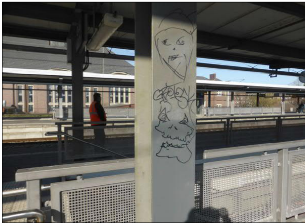
Abbildung 10: In Bremerhaven Hbf waren einzelne Dachstützen bekritzelt.
