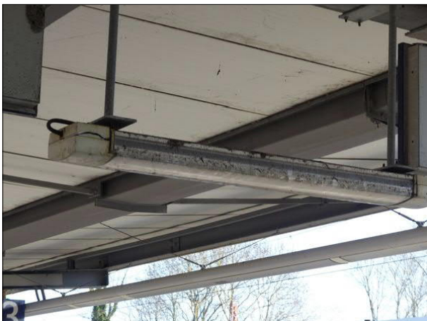
Abbildung 45: An den Treppenabgängen von Bremerhaven Hbf waren die Leuchten verschmutzt.
