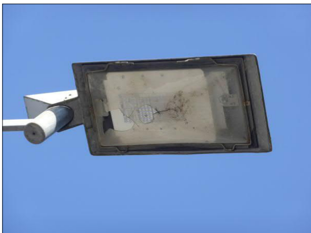
Abbildung 38: Eine Leuchtenhaube auf dem Bahnsteig in Bremerhaven-Lehe war beschädigt.
