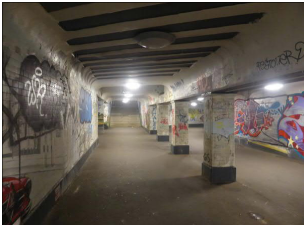
Abbildung 34: Zahlreiche Schmierereien, Verschmutzungen und Schäden sind das Ergebnis einer offensichtlichen Vernachlässigung der städtischen Unterführung am Bahnhof Bremen-Sebaldsbrück
