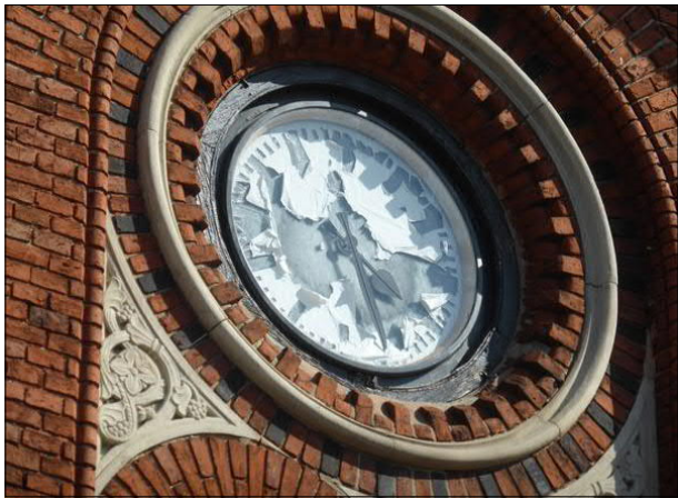
Abbildung 19: Die Uhr an der Westseite des Bahnhofsgebäudes von Bremen-Vegesack ist seit mehr als zwei Jahren defekt. In diesem Zustand beeinträchtigt sie stark das Erscheinungsbild.
