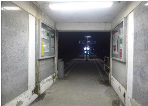
Abbildung 49: Die Treppeneinhausung auf dem Bahnsteig in Bremen-Hemelingen ist beschädigt, so dass an mehreren Stellen der Wände und der Decke Wasser in das Bauwerk eindringt.
