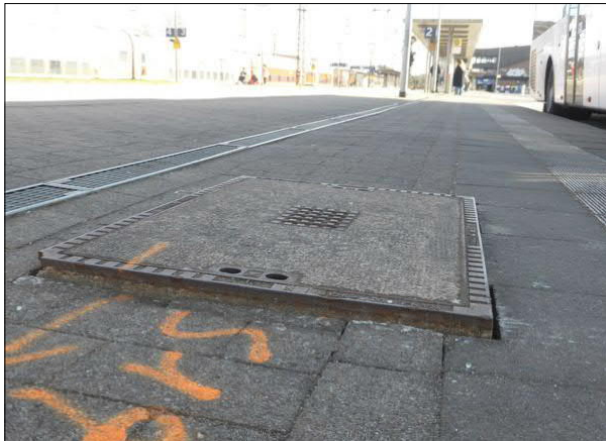
Abbildung 8: Im nördlichen Bereich des Bahnsteigs an Gleis 2 in Bremen-Burg lag ein Schachtdeckel rund 3 cm höher als das Bahnsteigpflaster.
